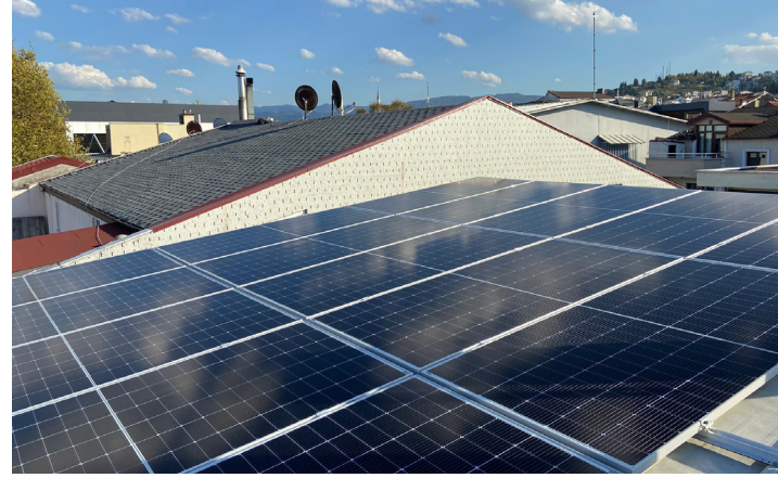
Lokasyon : Düzce, Türkiye Kurulu Güç : 30.5 kWh
