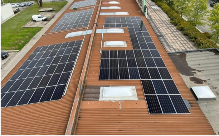
Lokasyon : Augsburg, Almanya Kurulu Güç : 95.46 kWh
