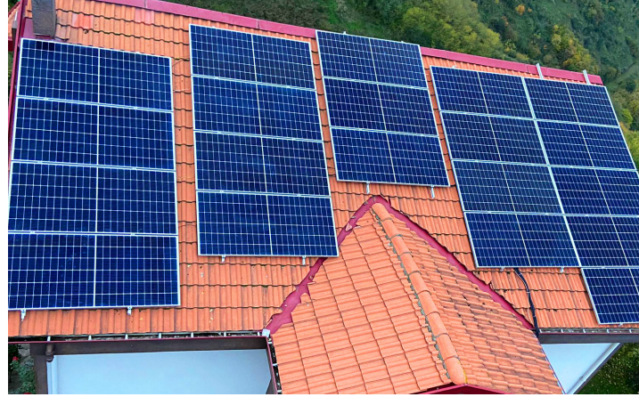
Lokasyon : Trabzon, Türkiye Kurulu Güç : 9.1 kWh
